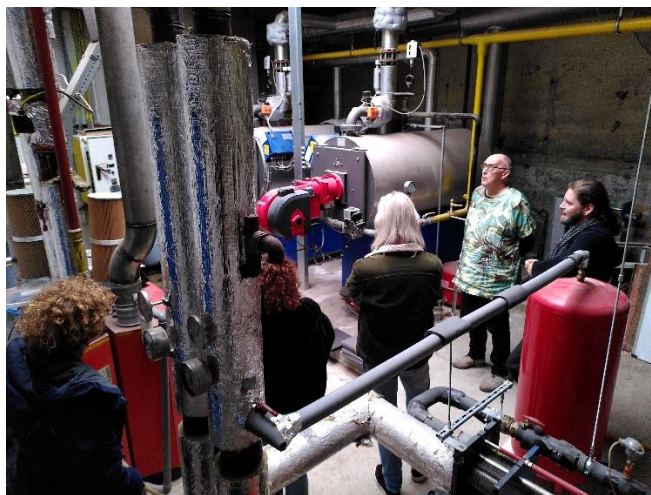
Bewoners schrikken niet terug voor onderhoud aan complexe installaties
